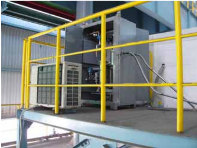
Площадка с БКК в месте отбора газовой пробы СЗ
