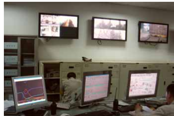
Главный пульт управления на установке вакуумирования стали
